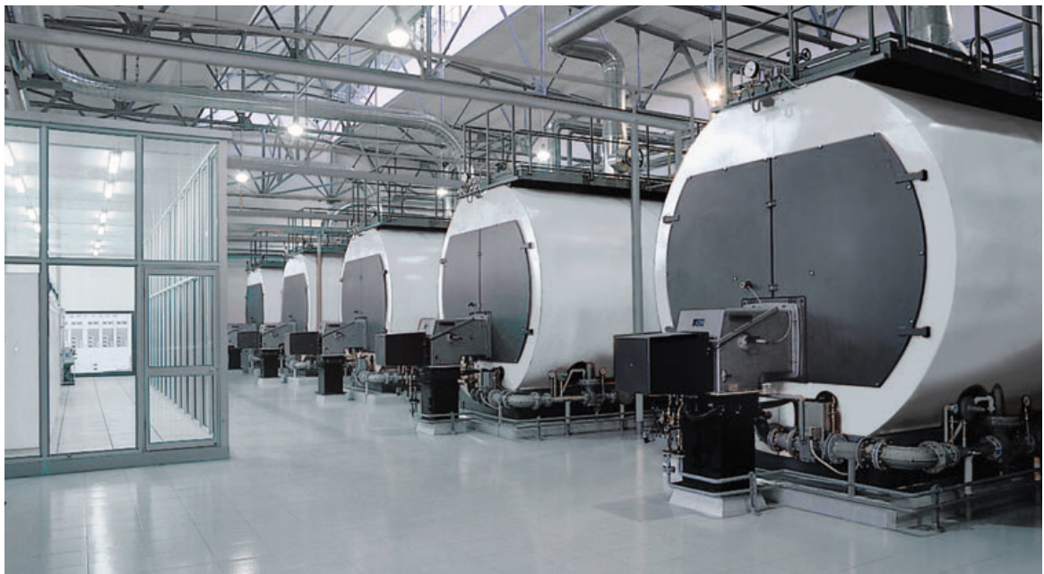
Abb. 91: Fünf gasbetriebene Hochdruckdampferzeuger für jeweils 16 Tonnen Dampf pro Stunde und 10 Bar Betriebsdruck
