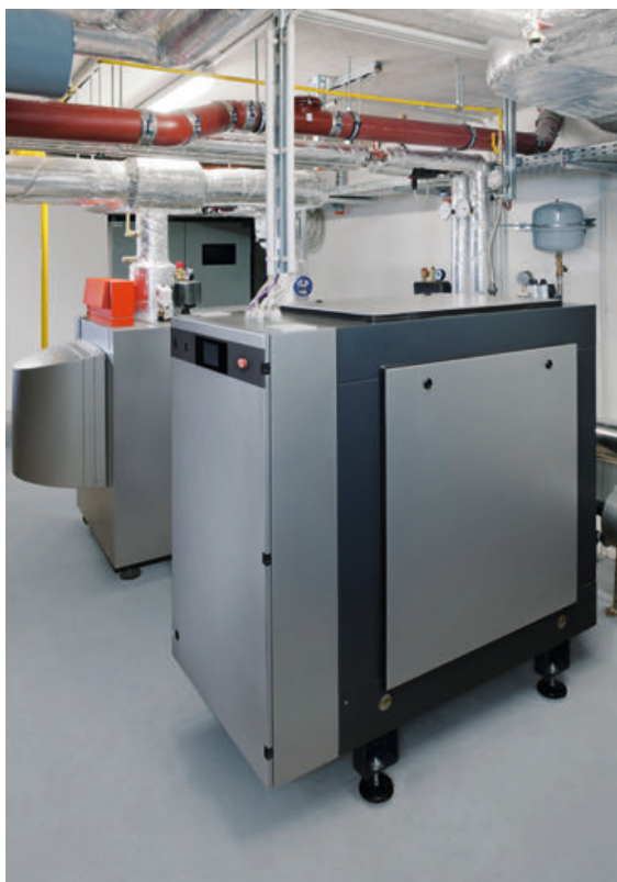
Abb. 47: Blockheizkraftwerk in Verbindung mit einem Spitzenlastkessel zur Versorgung eines Apartment-Gebäudes.
