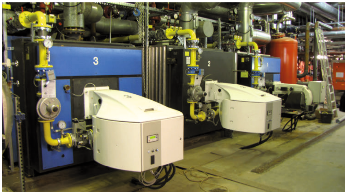
Abb. 92: 167 Tonnen Heißdampf pro Stunde können die Kessel für den Antrieb der Dampfturbine sowie zur Unterstützung der Fernwärme- versorgung bereitstellen
